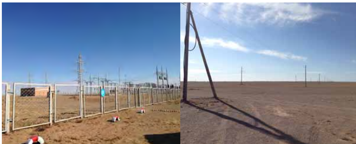
図 87 タバントルゴイ変電所 348
