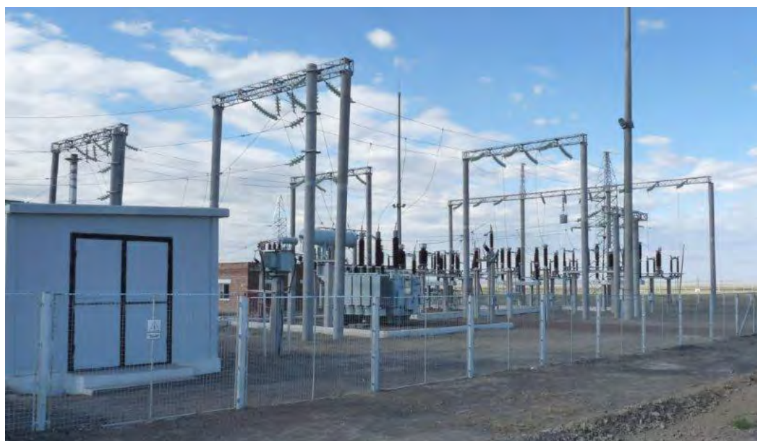
図 51 ダランザドガド変電所 260
