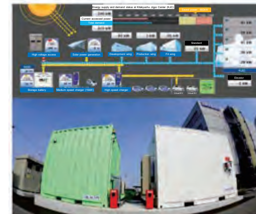
รูปภาพด้านบน : การแสดงสถานะอุปทานและอุปสงค์ของพลังงานด้วย NS-ELEX BEMS รูปภาพด้านล่าง : แบตเตอรี่จัดเก็บพลังงานขนาดใหญ่ ขนาด40kWhอยู่ทางด้านซ้าย และขนาด50kWhอยู่ทางด้านขวา
