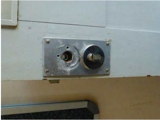
写真 11 壊れたままのドアノブ (ガザ州シサノ校)
