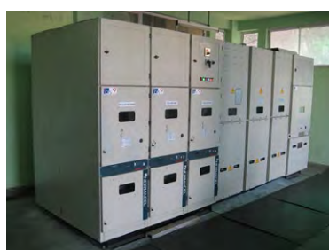
11KV スイッチギアパネル
