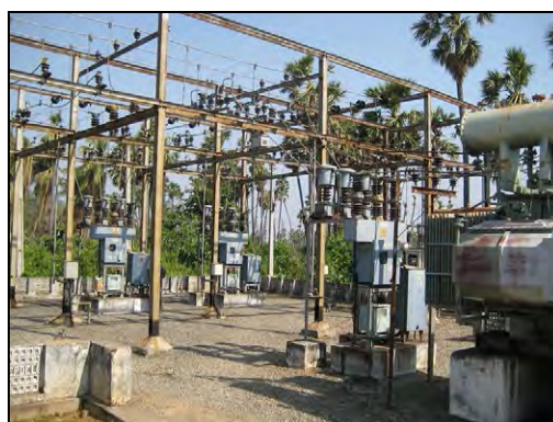
本事業で整備した変電所 (アンドラ・プラデシュ州)
