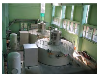
発電機 (1号機、2号機)
