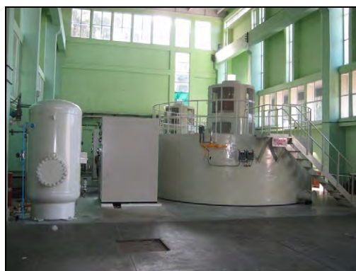
ウミアム第2水力発電所の発電機
