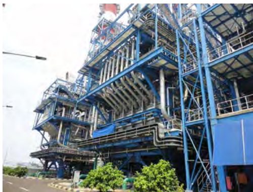
排熱回収ボイラー
