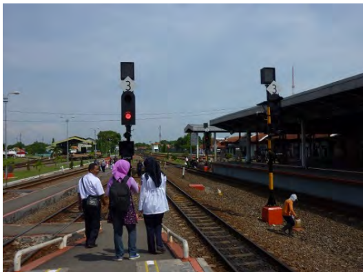
写真 7：整備された信号機器
