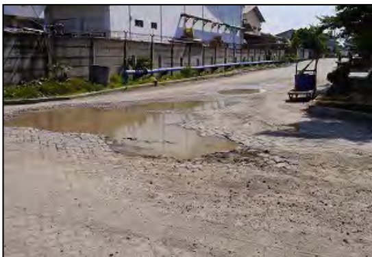
写真 17：破損で水たまりができています 港内道路（事後評価時）
