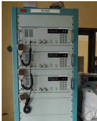
GMDSS (VHS/DSC) 機材 (カリアンゲット局)
