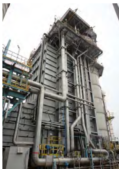
排熱回収ボイラー
