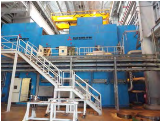
ガスタービンが入っている施設
