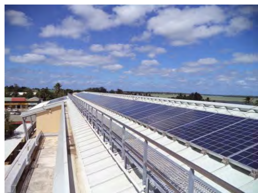
本事業で設置した太陽光パネル
