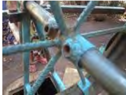
写真5 ボルトを外されて稼働しなくなったロー プポンプのホイール（ワライタ県ボロソレ郡） （撮影：評価者）
