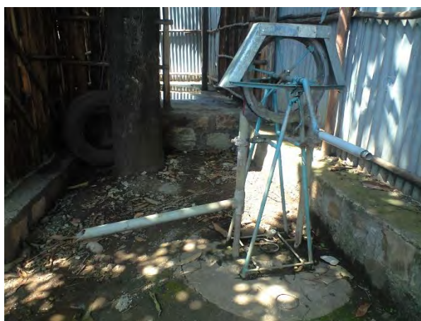
本事業にて設置された世帯用ロープポンプ 2
