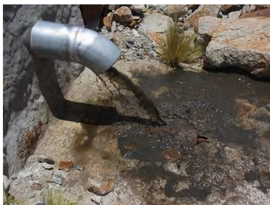
排泥施設からの排泥の様子
