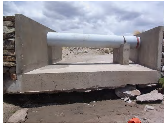
導水管保護工基礎部分の洗掘
