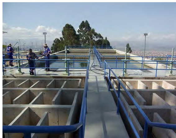
アランフェス浄水場
