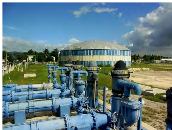
浄水場に隣接する配水池と配水ポンプ
