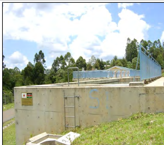
カプサベット市浄水場第1沈殿池
