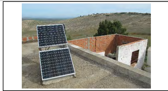
本事業により設置された太陽光パネル (シリアナ県)
