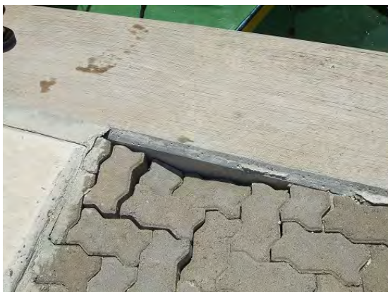
Fonadhoo 港湾 岸壁のへこみ (他の港湾にも同様のへこみあり)
