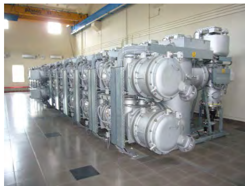
ケラニッティッサ変電所内部
