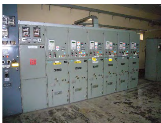
変電所”H”内部
