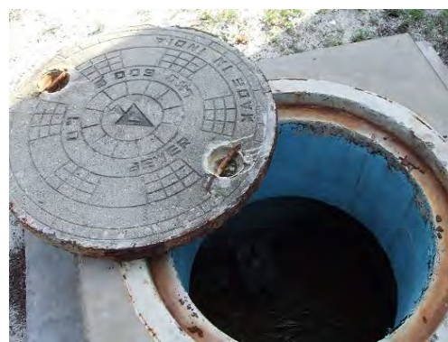
下水道ポンプ場 Eydhafushi
