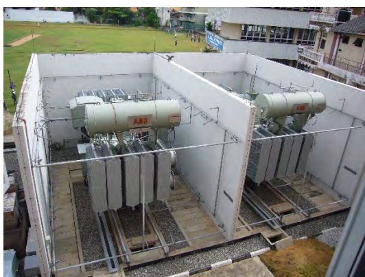
変電所”H”外部設備
