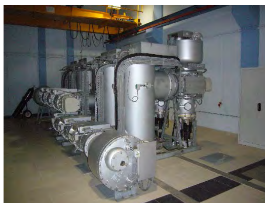
変電所 C 内部
