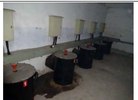
写真5 本サブプロジェクトで追加設置 された排水汲み上げポンプ
