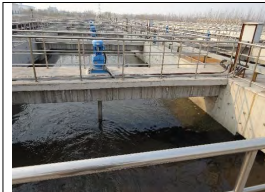
写真4 「達道湾下水処理場」 19 の 一次沈殿池
