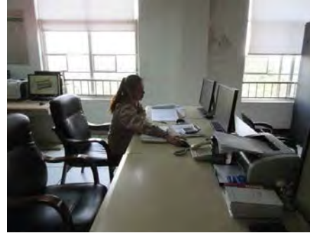
写真5 琅東下水処理場第2期 中央制御管理室
