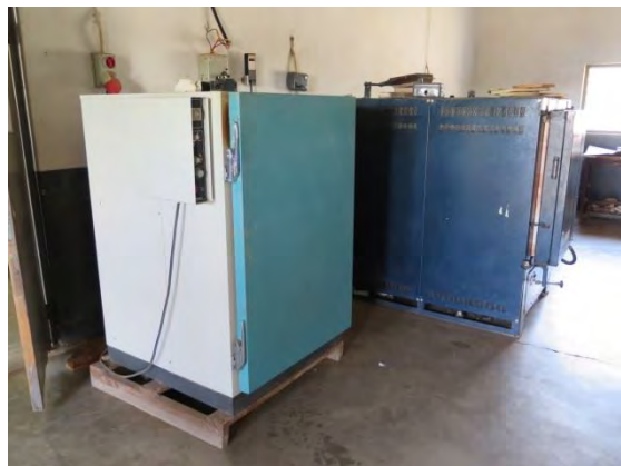
6 : 電気炉 (故障中)
