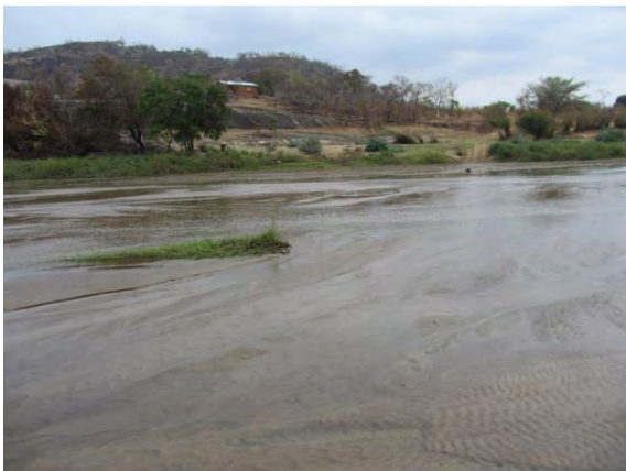
5：季節外れの降雨後の河川横断道路の状況（Mzimba 地域）
