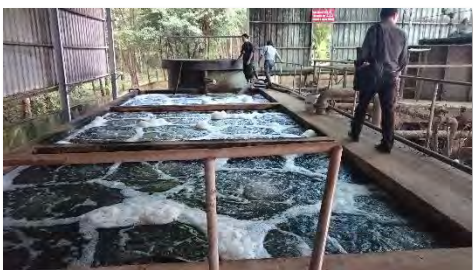
VINH PHU 製紙工場の排水処理施設
