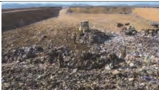
Travaux d'épandage des DMA dans l'aire au fond à droite dans la fosse
