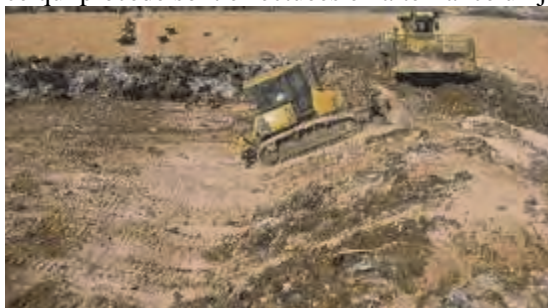
Travaux de couverture après le compactage dans l'aire au fond à droite dans la fosse
