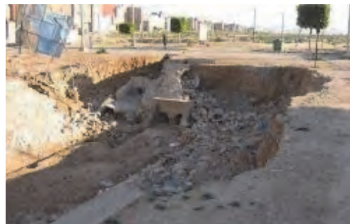
Endroit endommagé par l'érosion due aux écoulements d'eau lors d'inondations dans la commune.
