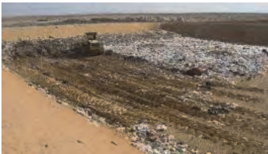
Travaux d'épandage des DMA dans l'aire au fond à gauche dans la fosse
