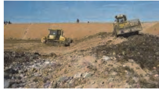
Travaux de couverture après le compactage dans l'aire au fond à gauche dans la fosse
