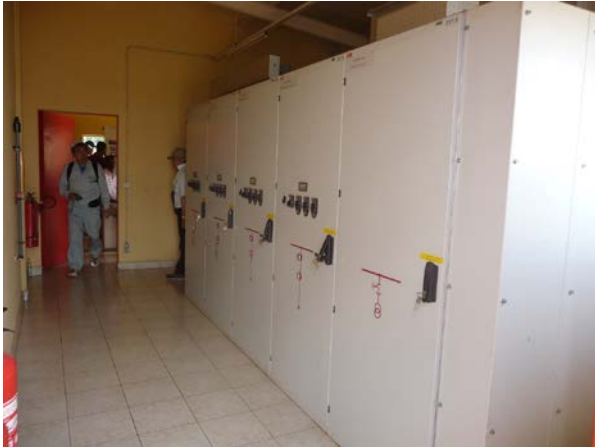
ガソギ変電所の 15 kV 開閉設備(既設)の様子
