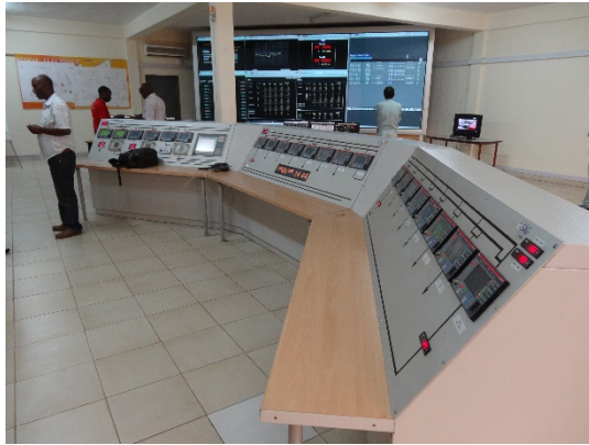
図 2-1-4.1 総合給電指令所の制御室
