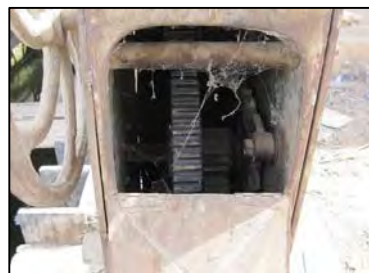
写真：ダイリュート堰群上流側の開閉機(接写)
