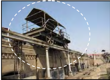
写真：ダイリュート堰群下流側の開閉機
