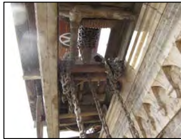
写真：ダイリュート堰群下流側の開閉機(下面)
