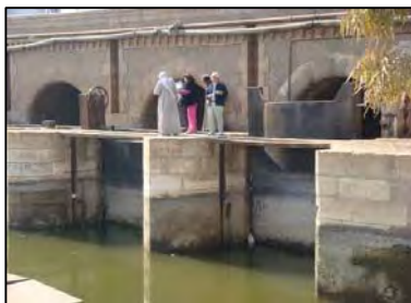
写真：ダイリュート堰群上流側の開閉機
