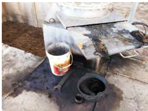
ダンパから漏れ出す木酢液
