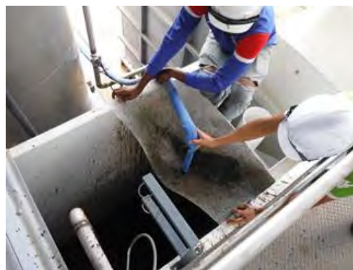
好気種汚泥移送
