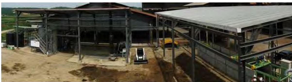
パイロットプラント建設後 写真 (1)
