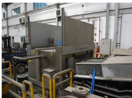
写真 3. 未使用のメンテナンス機器（Wheel-set washing machine）
