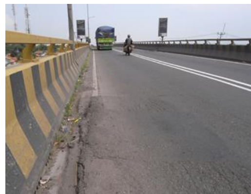
写真6. ゲバン高架橋のパッチ補修箇所と開かなくなった排水溝
