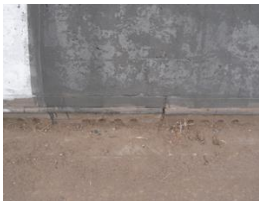
写真5. バララジャ高架橋の路肩の状況（清掃後も排水溝内に砂塵が溜まっている）
