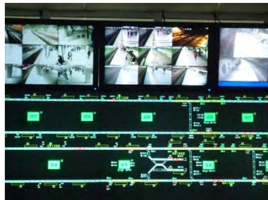
リモート監視・制御システム
