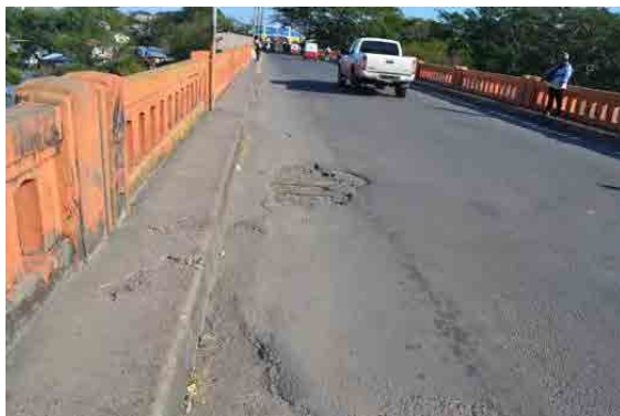
旧橋の路面の損傷
