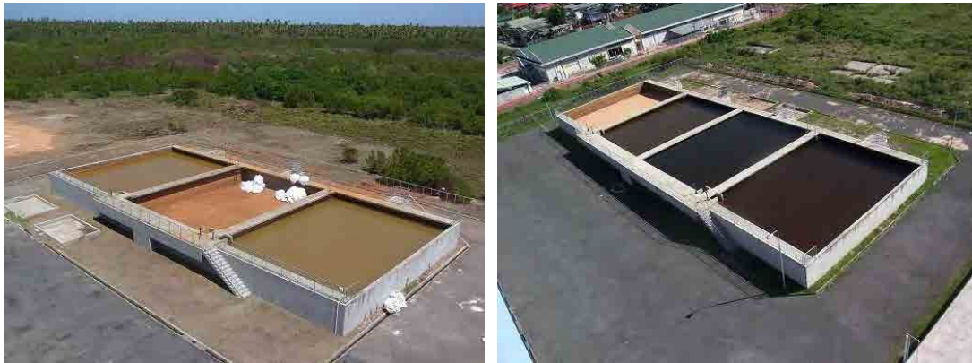
56 番集落浄水場（左）、クイーンズタウン浄水場（右）の緩速ろ過池 17
