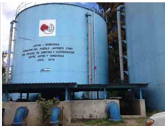
オリンポ I 配水区の配水池
