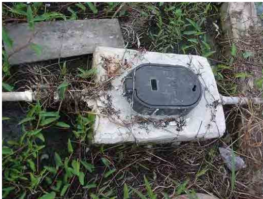
設置された水道メーター
