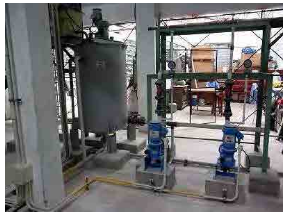
ピカチョ浄水場のアルミニウム凝固剤投入設備
