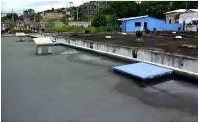
ラ・ソサ配水区の配水池
