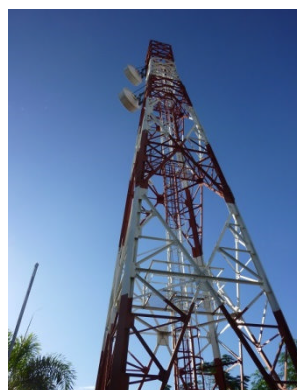
写真6：整備された通信鉄塔
