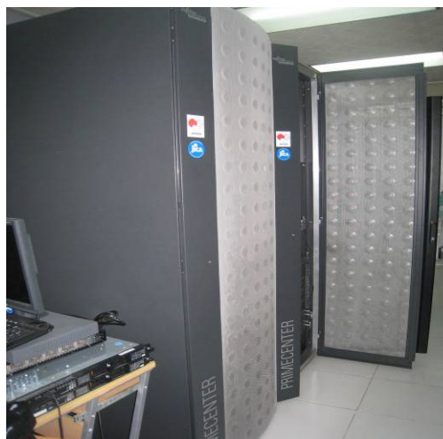
整備されたサーバー
