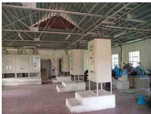
写真1 サテニ配水場の送水ポンプ室
