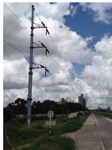
写真 2 道路留保地に建設された送電ポール
