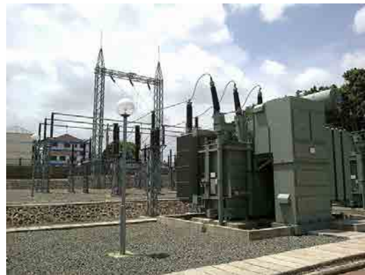
本事業により整備された マクンブショ変電所
