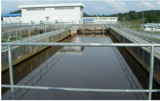
Kuala Sawah STP
