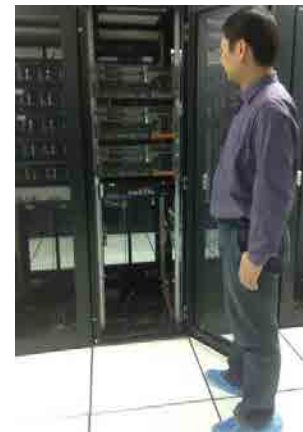
図書館に設置したデータサーバー室。セキュリティや衛生を厳しく管理。訪日教員が最適化設計を行った。（河南科技大学）
