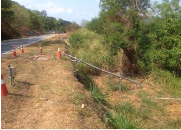
East-West Highway 沿いに設置した傾斜計
