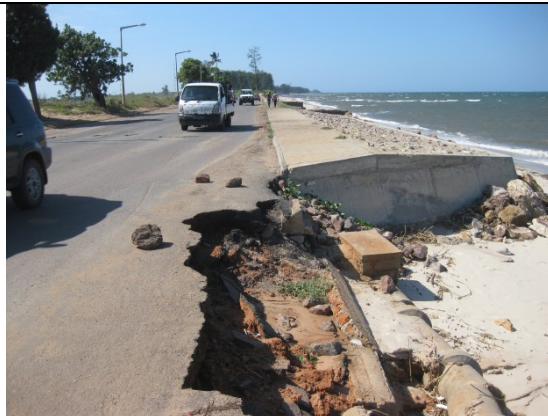
サイト南側の海岸線 浸食により道路の損壊が見られる。
