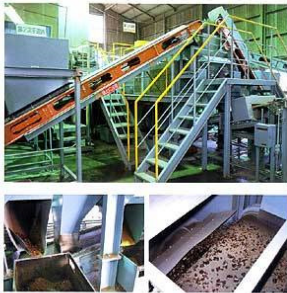
图 5-13 废玻璃处理设施
