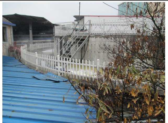
造纸过程中产生的废水的处理设施
