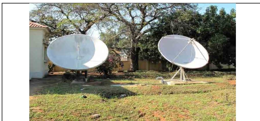
写真 33 左は GTS 回線接続用アンテナ、右側が METEOSAT-7 号の受信機
