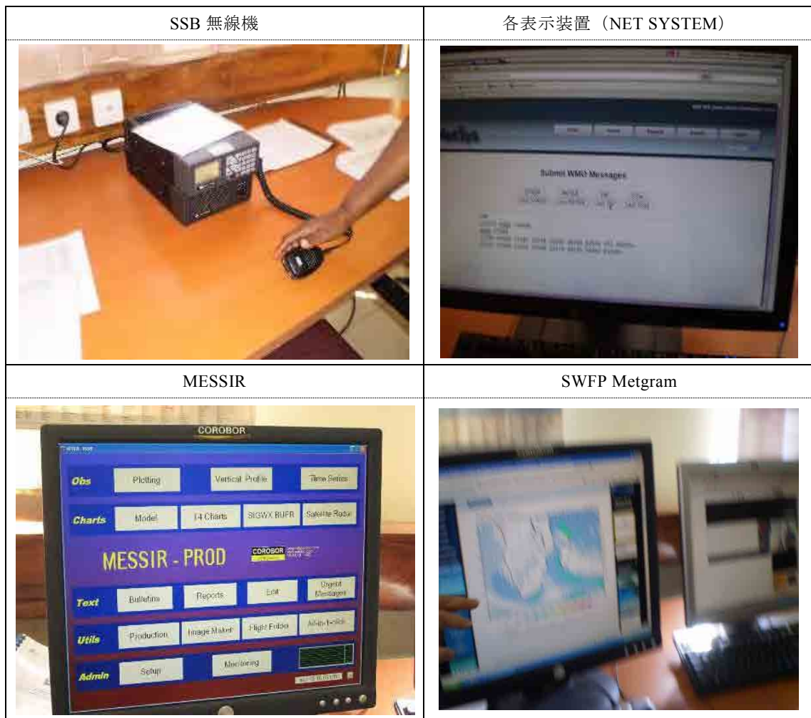
写真 37 予報現場に設置されている各装置
