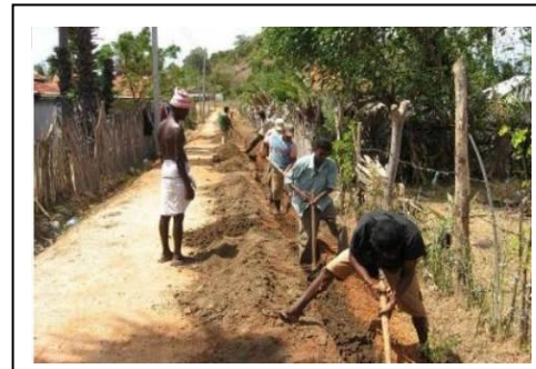
CMRによる給水事業工事の様子。 掘削と埋戻し作業に住民が無償で 労働力を提供した。 (2009年6月、ペルー村)
