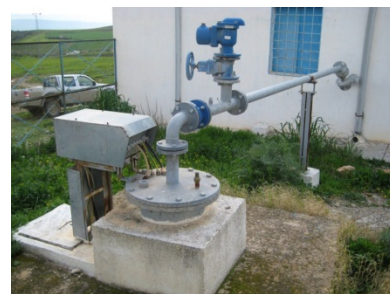
ポンプ機器 (Gmara 村、ベジャ県)
