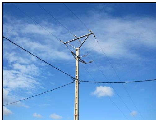
整備された配電網（エッサウィラ県）
