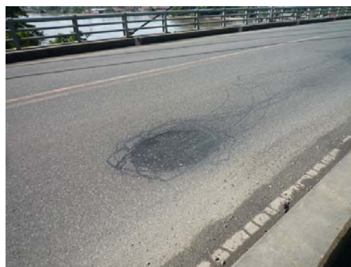
橋梁車道上のポットホール（補修後）
