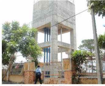
Elevated tank (Kong Tang)
