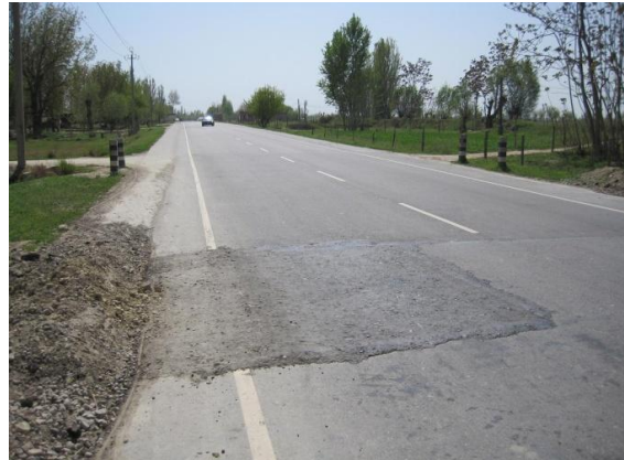
写真 5 損傷後再補修された路面（第 2 期区間：アスファルトが強度不足）
