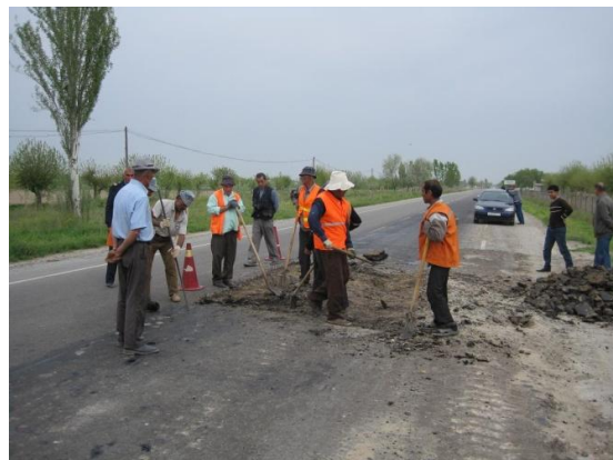
写真 3 維持管理事務所による補修地点の再補修作業（第 2 期区間）
