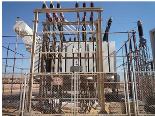
本事業で増設された変電設備
