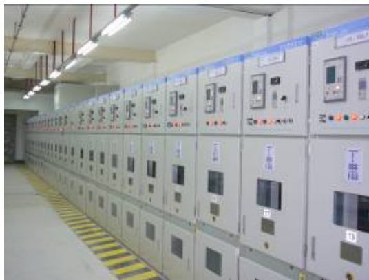
Kirza（キルザ）変電所改修機器
