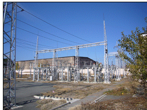
改修された Echmiatsin 変電施設
