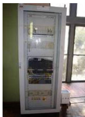
エレバン水力発電所に設置された SCADA 関連施設
