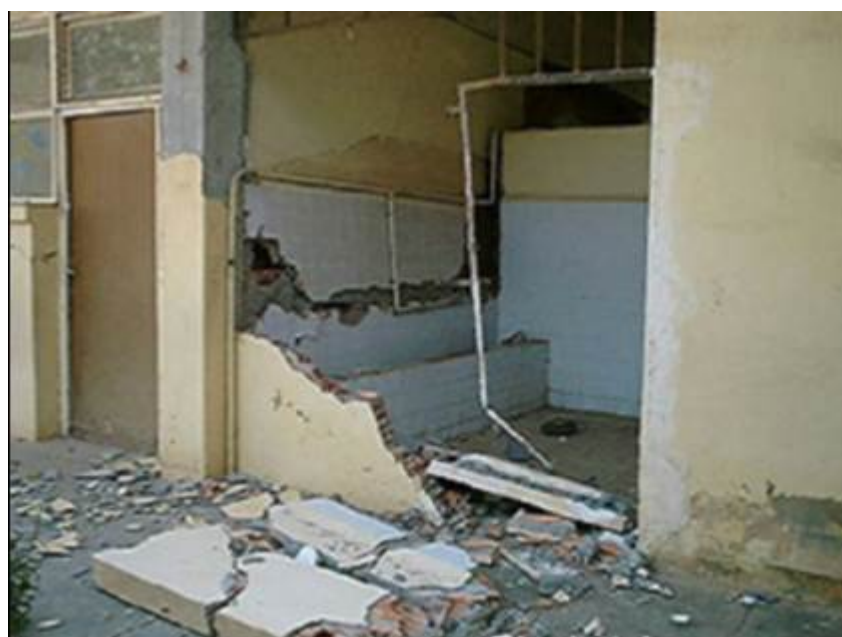
Figure 1 : à Boumerdès - Construction scolaire endommagée par le tremblement de terre (Boumerdes)
