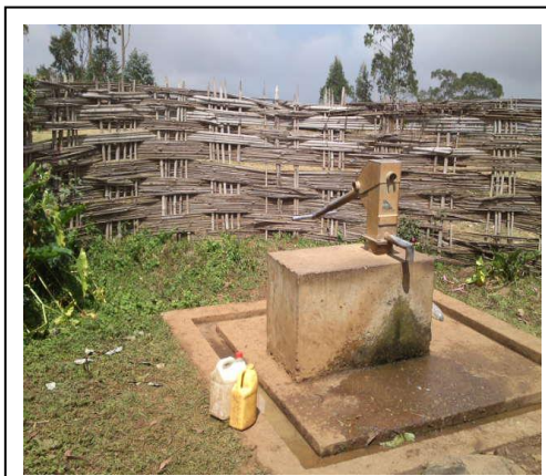
本事業による給水施設
