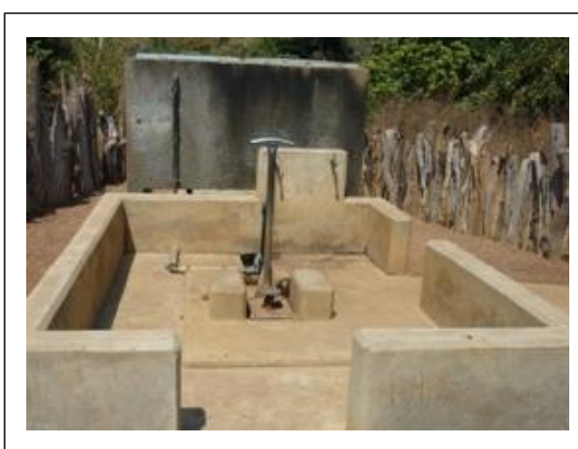
本事業による除鉄装置付き 足踏みポンプ付き深井戸給水施設
