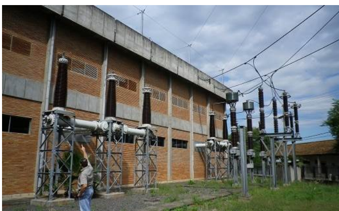
パルケ・カバジェロ変電所（未接続の受電施設）
