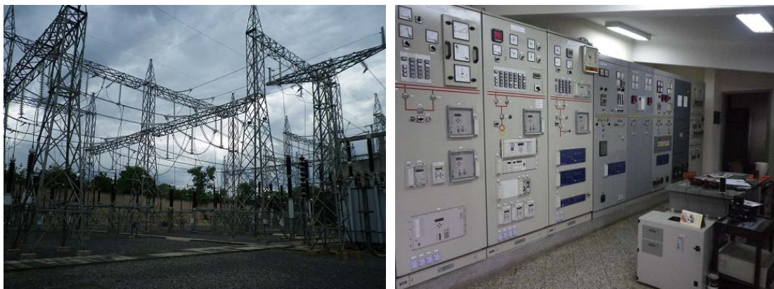
プエルト・サホニア変電所（左：開閉所、右：コントロール・ルーム）
