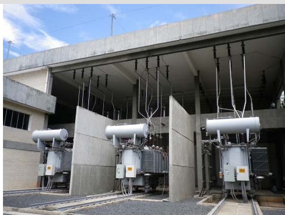
レプブリカーノ変電所
