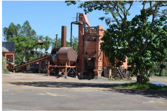
公共事業通信省地方事務所の アスファルト・プラント
