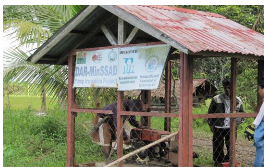
図1 本事業により新設したポンプ式灌漑施設（アグサン・デル・スール州・サンガブリエラ村）
