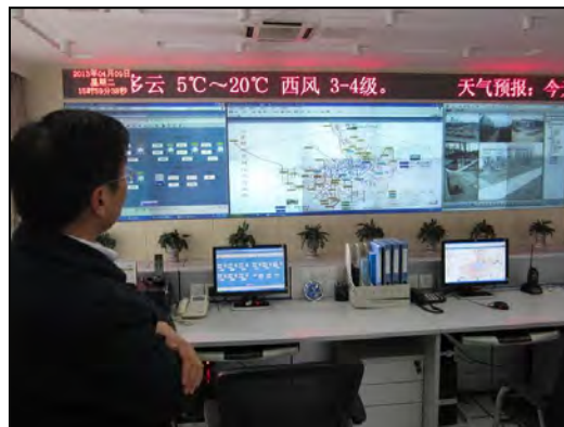
SCADA システム（合肥市）
