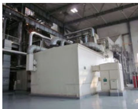
ガスタービン（防音用建屋内に格納）
