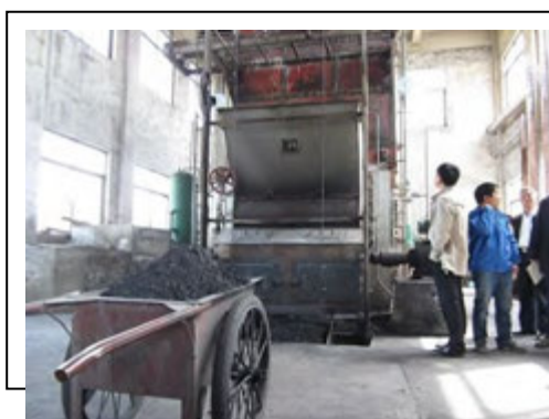
図 5 石炭ボイラー設備（滁州市内）
