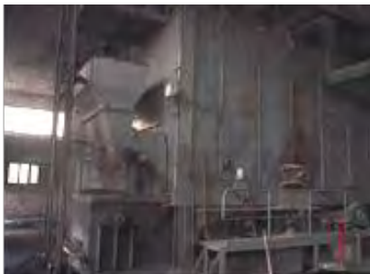
図2 廃止された小型石炭ボイラー
