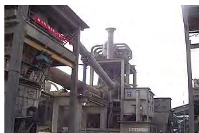
図7 貴州セメントの新発電設備 (事業実施後)
