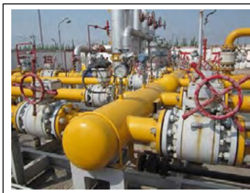
図 17 ゲートステーション内配管 (焦作)
