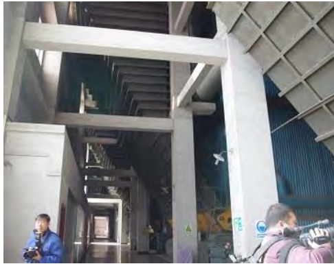
図 1 太原街集中熱供給 ボイラー
