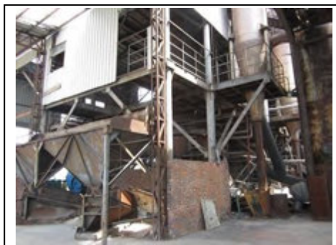
図 17 転換前の石炭熱ボイラー (平頂山市)
