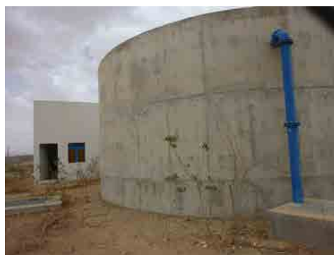
建設された配水池（マイディマ）
