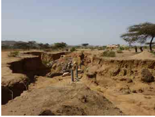
図 9：土壌浸食による送水管の遮断 42 (デケムハレ)
