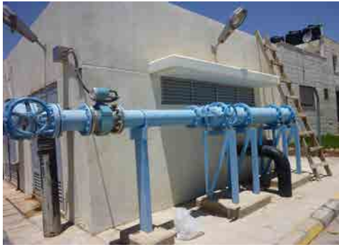
写真 5：更新されたポンプ設備 (バトラウィ・ポンプ場)
