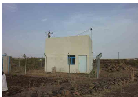
図 12：デバルワの井戸・ポンプ施設 (基礎部分・開閉ドアの位置が低く豪雨時に 浸水実績有り)
