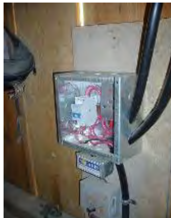
家屋内に設置された太陽光発電装置
