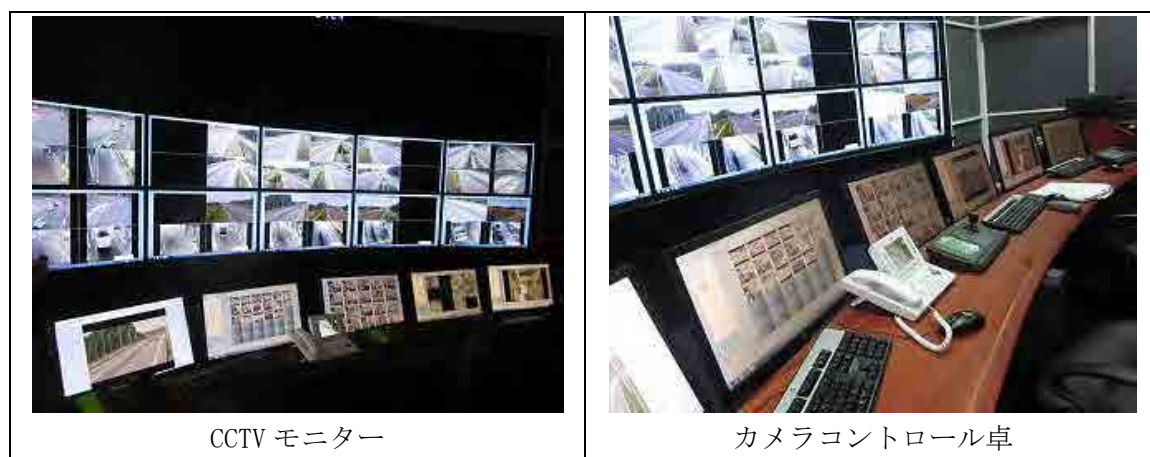
写真 2-1-3 CCTV カメラ監視センター
