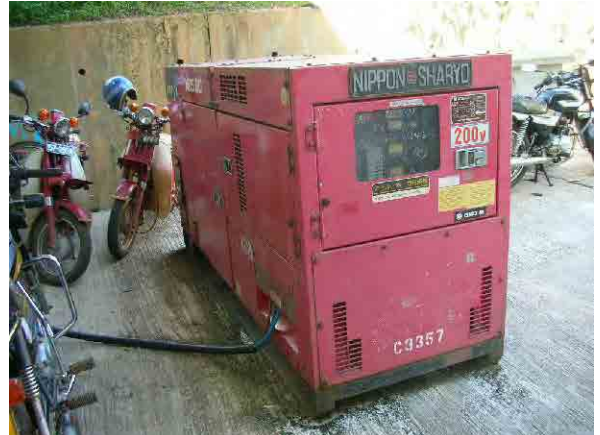
料金所の既存バックアップ発電機（暫定機器）
