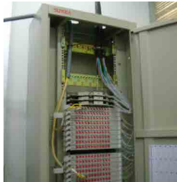
既存光ファイバケーブル用ラック
