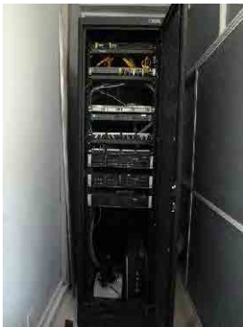
交通管制センター内既存サーバ
