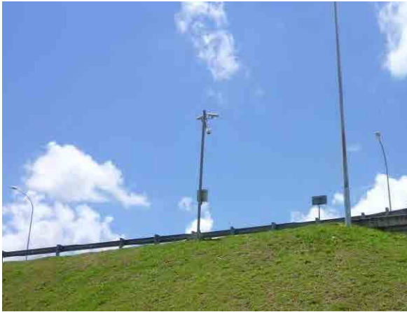
既存 CCTV カメラ
