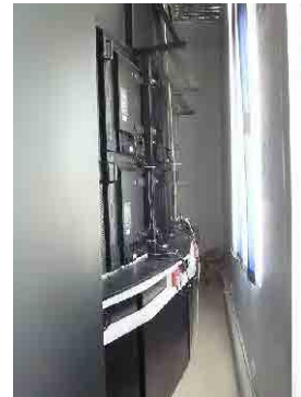
モニター背面の状況
