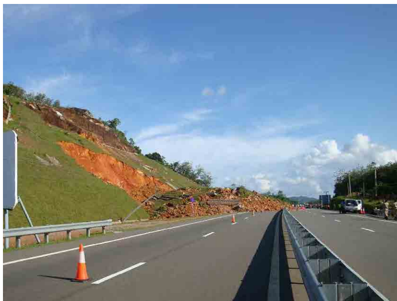
写真 3-2-1 SEW42.5km 東側切土斜面の崩壊現場(下り線全車線と上り線の1車線を封鎖)
