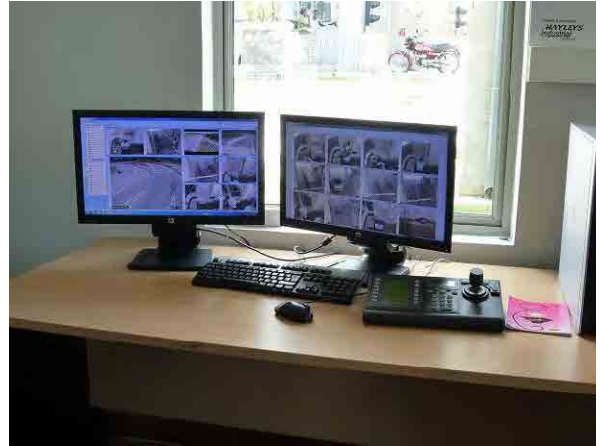
料金所の既存 CCTV モニタリングシステム
