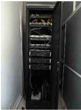
交通管制センター内既存サーバ
