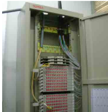
既存光ファイバケーブル用ラック
