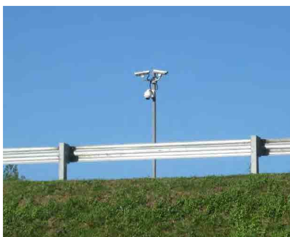
写真 2-1-2 CCTV 監視カメラ
