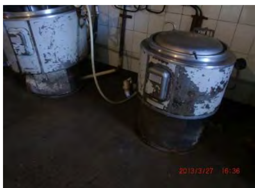
Фото2-3 Устаревшее оборудование находится в чистом состоянии
