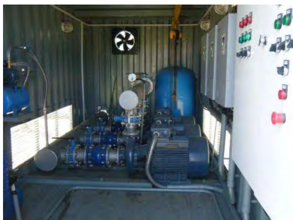
Фото 7-5 Бустерный насос для трубопровода
