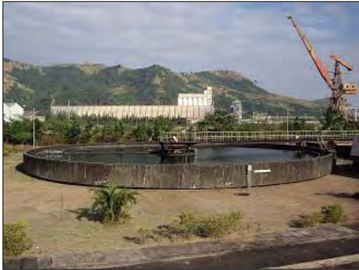
沈殿槽(バターン)
