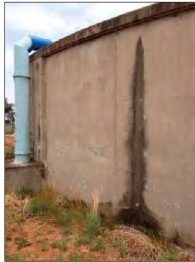
エカンガラ調整池 わずかだが漏水が見られる
