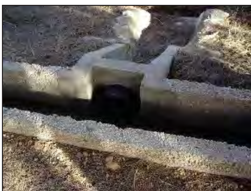
水路のコンクリート 塩害による表層剥離が見られる (3.3.3.1 及び 3.3.4 参照)
