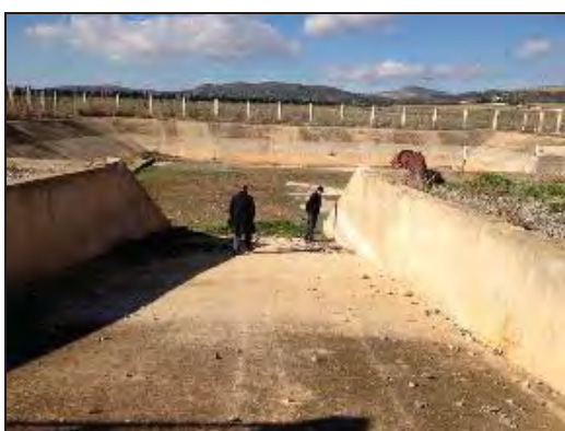
使用されていない空の貯水池 (ベジャ)
