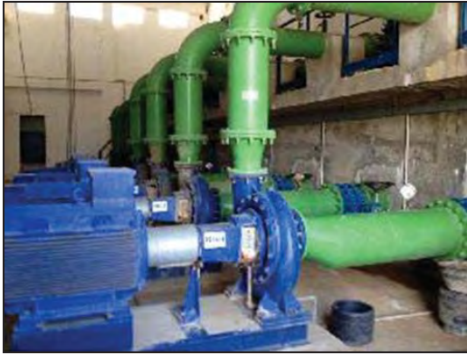
ポンプ施設（フェルナナ）
