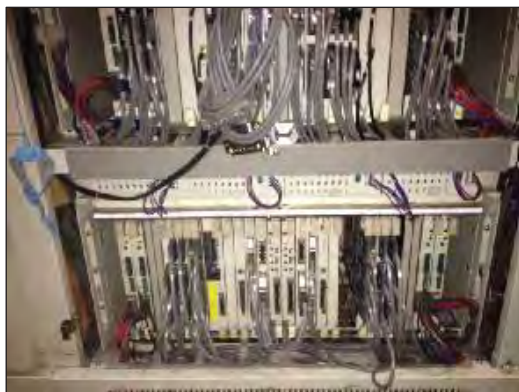
交換機ユニット 空きスロットが目立つ
