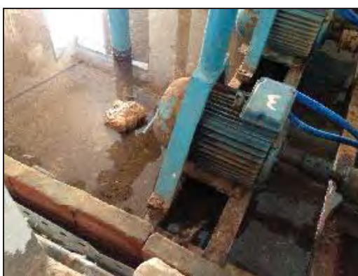
漏水により水が溜まっているポンプ場 (メドニン)
