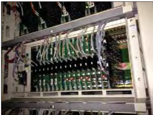
交換機 空きスロットが目立つ
