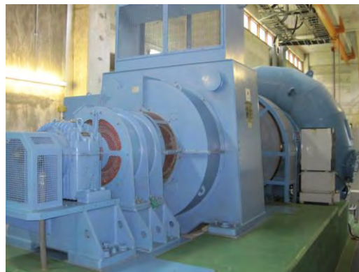
本事業で整備した発電機
