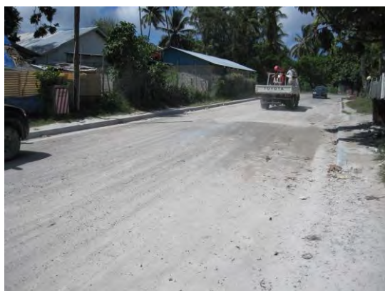
写真 2：舗装がはがれた対象道路 (タシレレイ道路)
