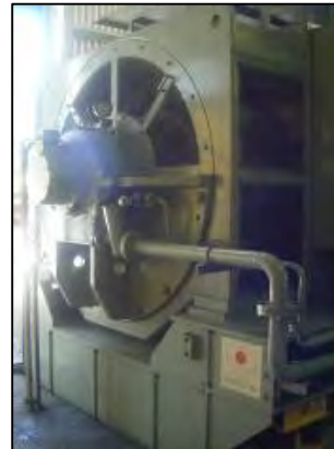
新設されたディーゼル発電機
