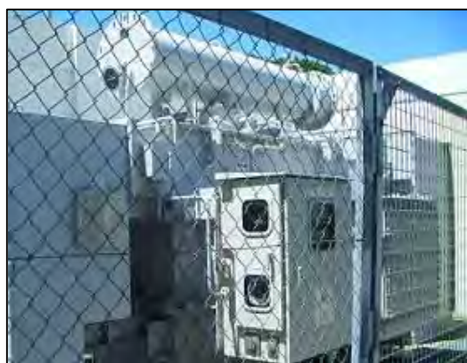
ラナディ変電所：主変圧器
